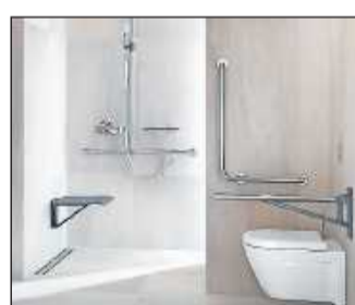
Eine ebenerdige Dusche und Haltegriffe sind Elemente für ein seniorenrechtliches Bad. FOTO: DJD/WZV EDELSTAHL/GRANBERG
